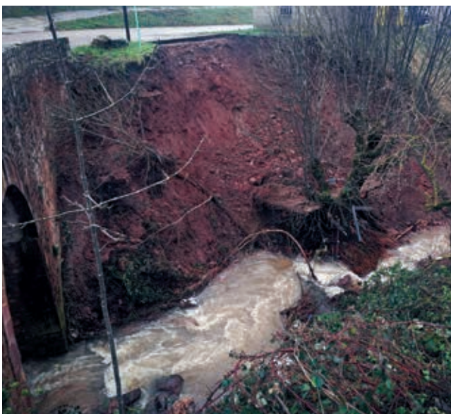
Estado en el que quedó el argayo de Villar
